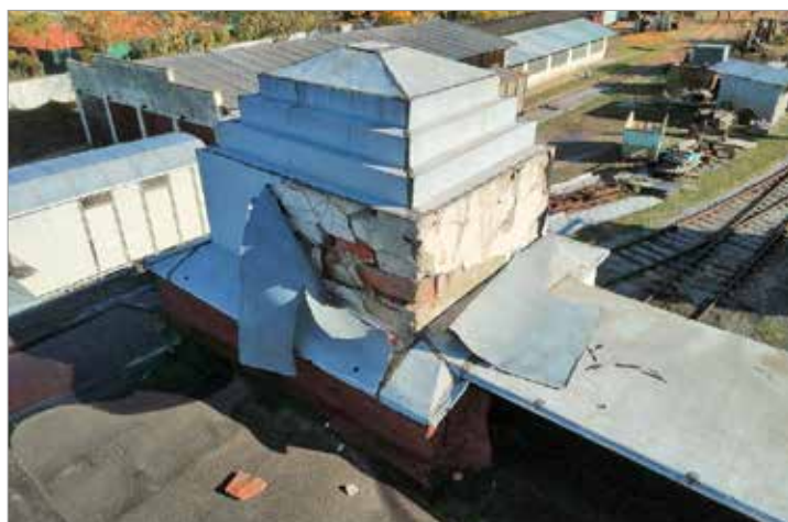
Überzeugender könnte der Unterschied nicht sein! Die Schutzverble- chung der Giebeltürmchen wies bereits beträchtliche Schäden auf, das stürmische Wetter besorgte den Rest.
