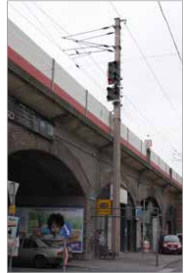
...zumal dieser Mast auch noch bis zum Boden reicht!
