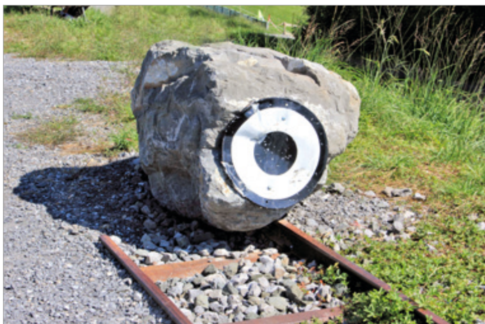
Ein recht kurioser, aber vorschriftsmäßig gekennzeichnete Gleisabschluss am Ende des Berichtes. Hier befand sich der Beginn des Bogens zur abgebauten Rheinbrücke nahe Mäder. Erfreulicherweise wird die Strecke hier um einige Meter geradeaus verlängert, um den von der Schweizer Seite zu Fuß kommenden Fahrgästen einen näheren und komfortableren Bahnsteig zu bieten. Foto: DI Helmut Bogner, 18.9.2021
