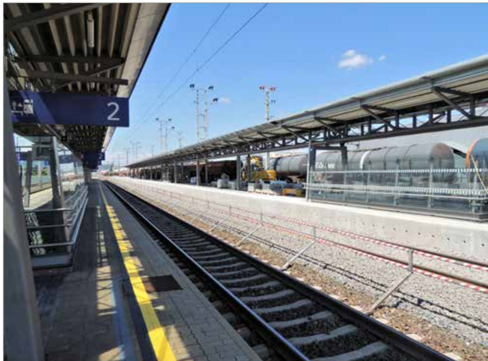
Bahnhof Graz-Puntigam; über den Gleisen am zukünftigen Nahverkehrs-Bahnsteig fehlt noch die Fahrleitung.
