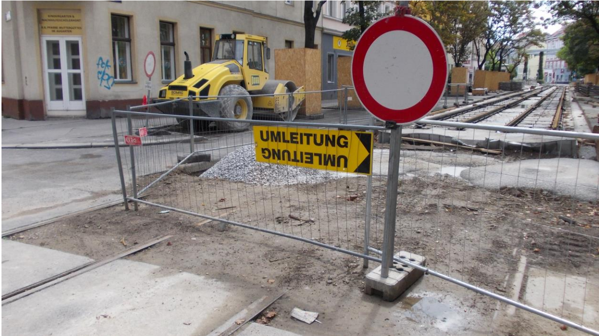
Für den Pkw-Verkehr heißt das "Umleitung" – Hinten die neuen Gleise und vor dem Warnschild noch die alten Schienen, die ebenfalls gewechselt werden (20.08.2017 11:45)
