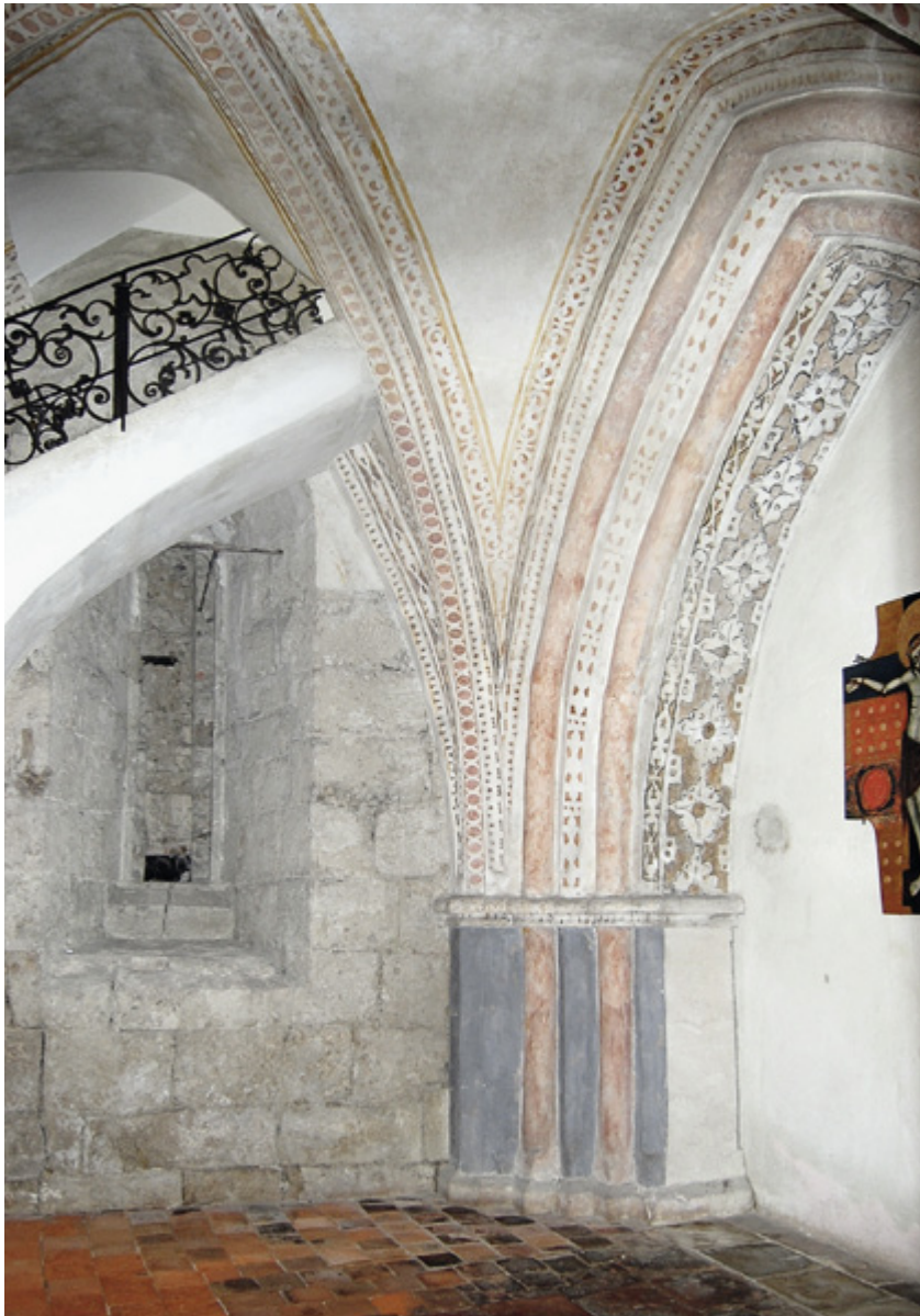
Abb. 198: „Läuthaus“ im Erdgeschoss des Nordturmes der Stifiskirche Kremsmünster
