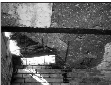
Kapelle: Dach noch schadhaft in 2008
